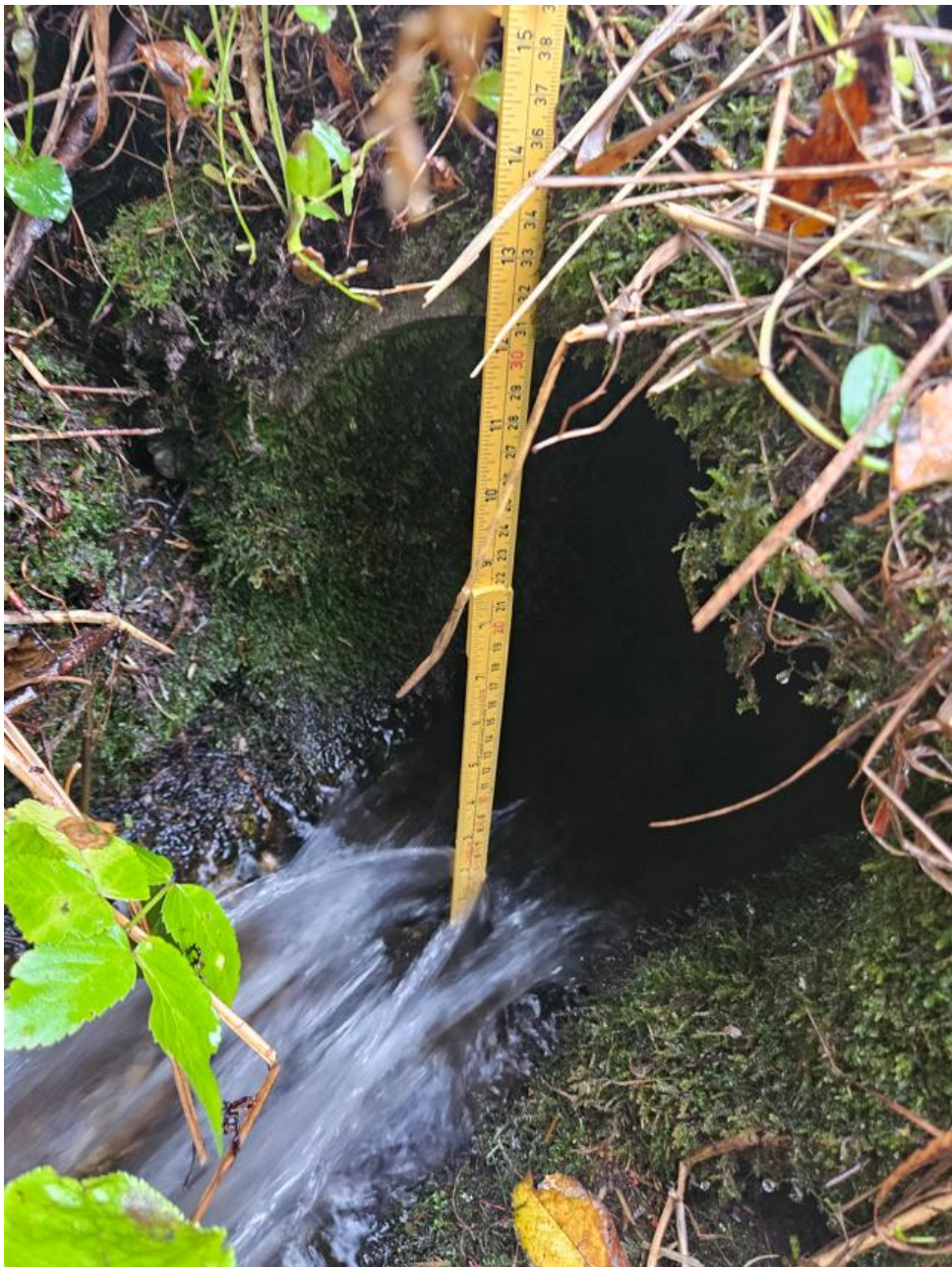
Figur 4: Foto av stikkrenne under Kursetstranda, 300 mm innvendig diameter. Det forventes å ha for lav kapasitet ved dimensjonerende flom.
