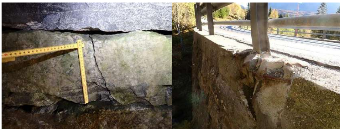
Utklipp 2 Skade på brufundament og rekkverk
