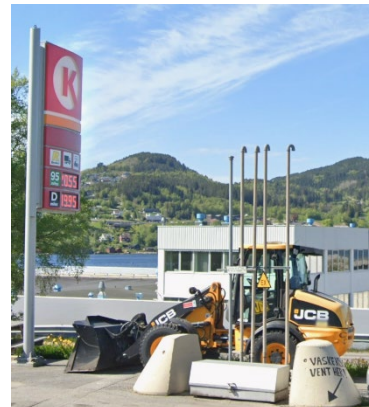
Fig. 6: Ex merket lufting
