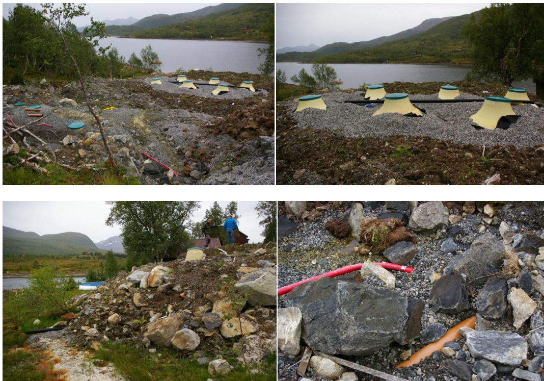
Figur 6: Renseanlegg for 8 hytter. Avløpsanlegget består av slamavskiller, pumpekum og 6 filterkummer med Leca. Anlegget er bygget i en løsmassefylling, setninger i løsmassene kan bli et problem. Utløpskum med rørledning til terreng. Stor stein ligger over avløpsledning. Foto: Odd Løvoll.
