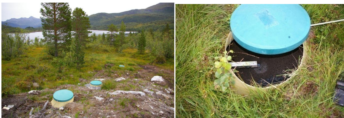
Figur 5: Kontroll av renseanlegg for 2 hytter. Avløpsanlegget består av slamavskiller, pumpekum og 1 filterkum med Leca. Filterkummen er overbelastet og vannmettet. Frodig vegetasjon nedenfor filterkummen, grunnet utslipp av urensset avløpsvann. Foto: Odd Løvoll.
