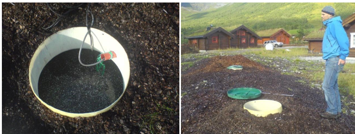
Figur 7: Kontroll av felles renseanlegg for 10 hytter. Avløpsanlegget består av slamavskiller, pumpekum, filterkum med Leca og våtmarksfilter med utslippsledning til bekk. Det ble registrert oppstuvning i pumpekummen, pumpe var ute av drift. Foto: Knut Robert Robertsen.
